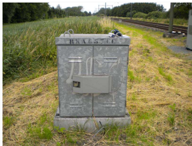
Voorbeeld van een relaiskast
